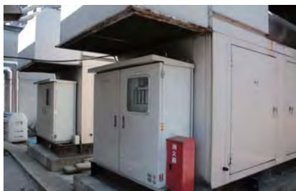
自家発電装置 170KWH 2台 (計 340KWH) 6600V を発電
