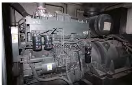
自家発電装置内部
