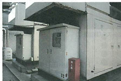
自家発電装置。2台で340KWH、6600Vを発電
